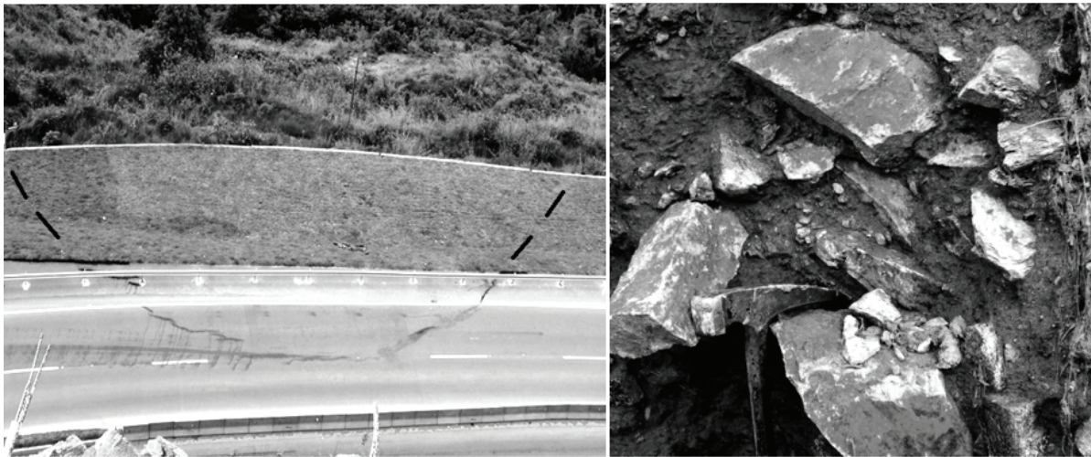
Figura 3: a) grietas que evidencian la reactivación del movimiento, vista desde arriba de parte de la calzada (Marzo del 2012). b) unidad de depósito de vertiente fresco (martillo geológico como escala).
