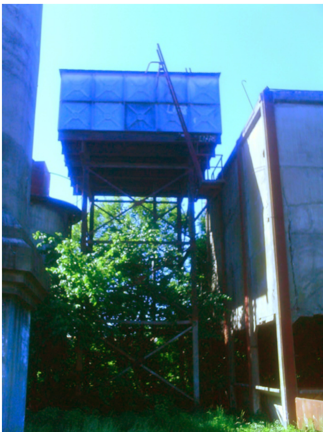
Figura 7. Tanque Piggot junto a torre de enfriamiento de usina
