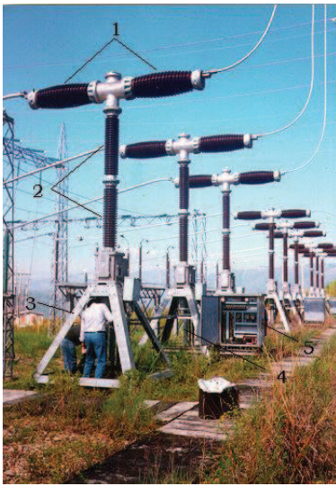
Figura 2. Interruptores de potencia tipo FL245.
