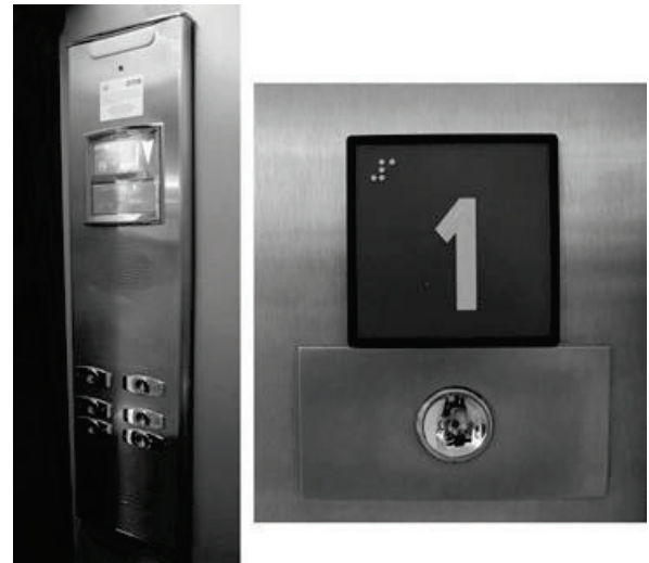
Figura 9. Cuadro de mandos ascensor. Fuente: foto tomada por los autores
