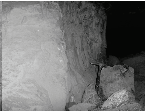
Figura 8. Pilar mostrando falla por esfuerzos inducidos progresivos originando lajamiento lateral o spalling , Batolito de Segovia, Antioquia.
