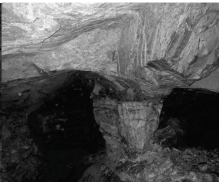
Figura 11. Pilar que muestra fracturas axiales y laterales inclusive en el núcleo del pilar (deterioro mecánico) y oxidación (deterioro químico), la inestabilidad se observa continuar a través de las fracturas paralelas, en rumbo y buzamiento, a la veta cuarzosa principal. El proceso se manifiesta en desprendimientos de bloques e indicios de spalling o lajamiento a media altura, proceso que es típico de un estado medio o avanzado de falla. El Bagre, Antioquia.
