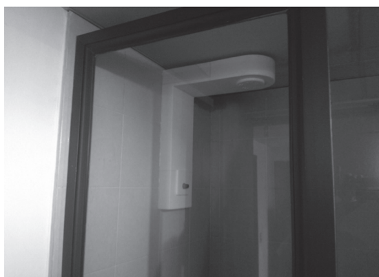
Figura 5. Proyecto final en funcionamiento
