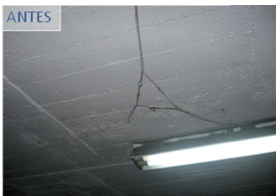
Foto 2. Cableado antes de mantenimiento
