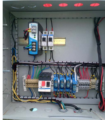
FIG. 14. Gabinete de control
