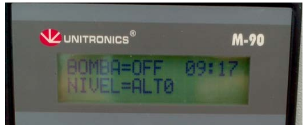
Fig. 11. Display de estados del nivel y la bomba
