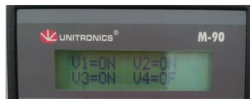
Fig. 12. Display de estado de las válvulas
