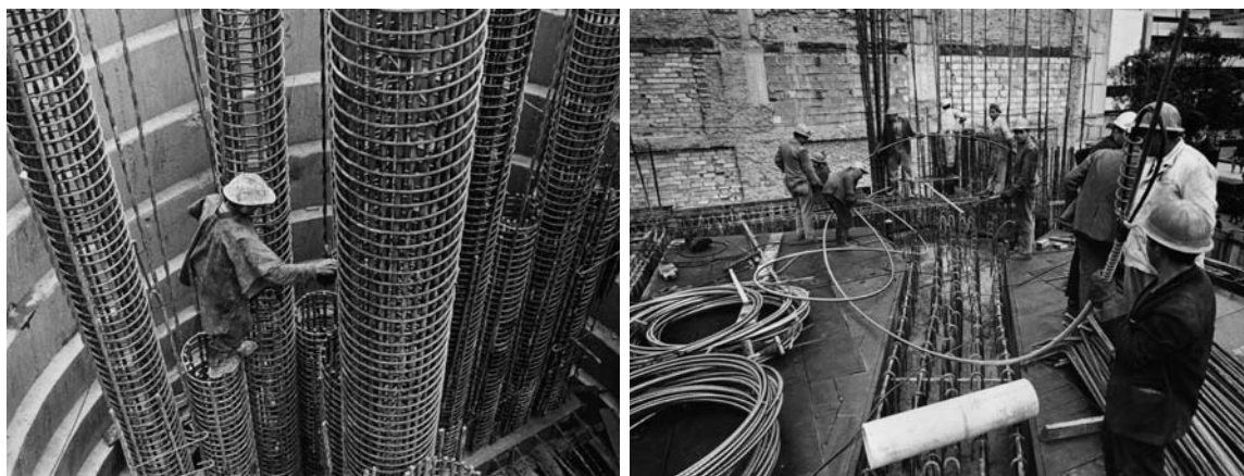
Cimentación y postensado. "Edificio Avianca" S.F. Esguerra, Sáenz, Urdaneta, Samper y Cía. Propiedad: Rafael Esguerra Arquitectos.
