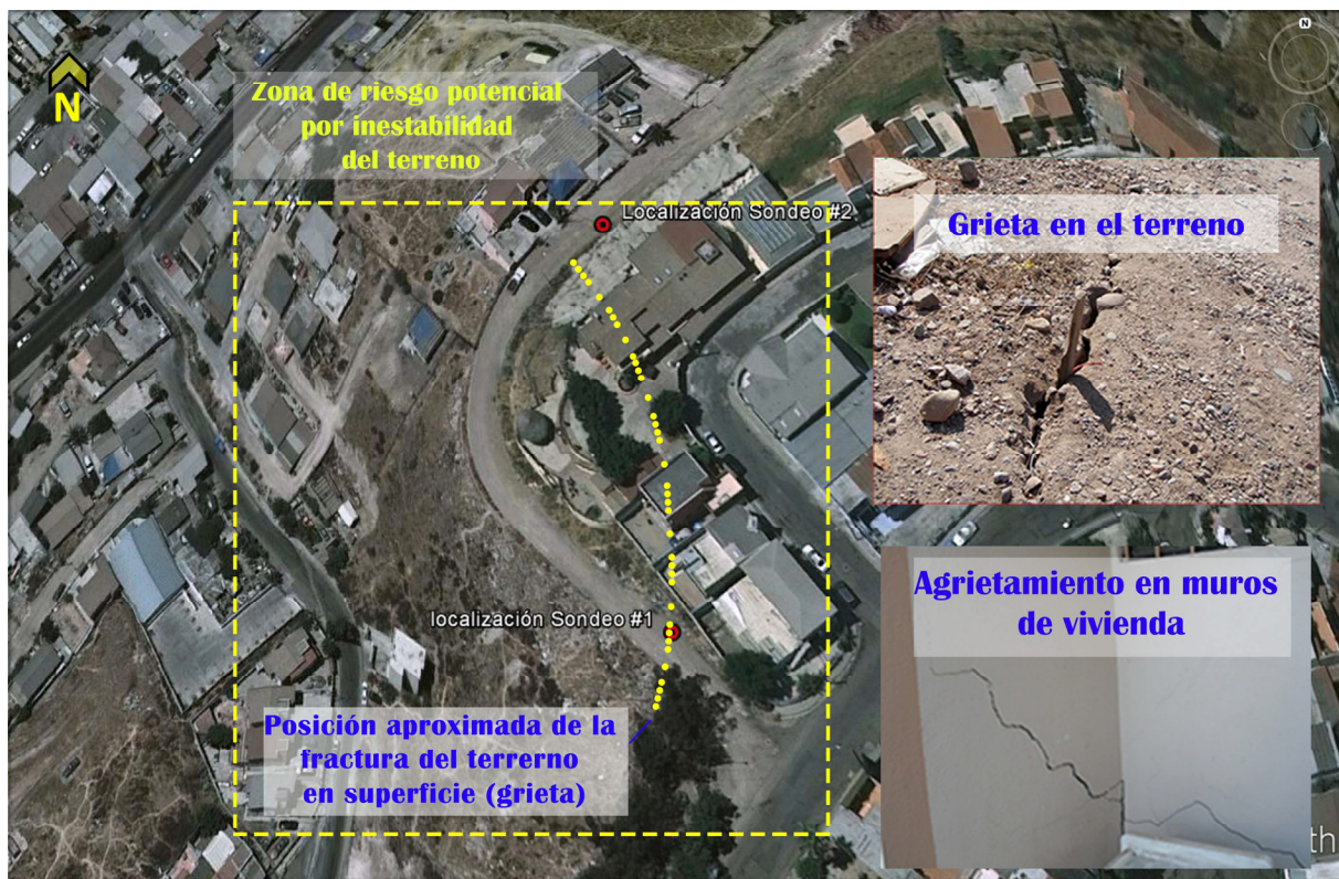
Figura 1. Zona de riesgo potencial por deslizamiento
